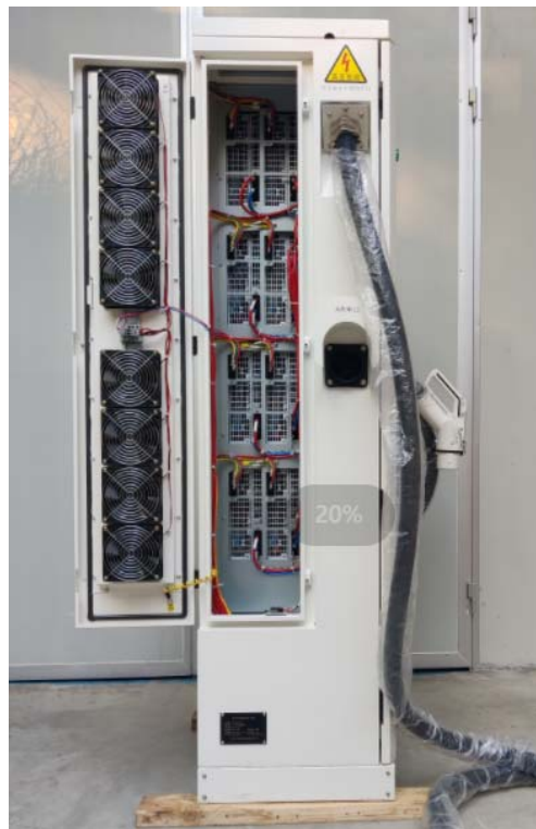
图 5 充电桩侧面内部
