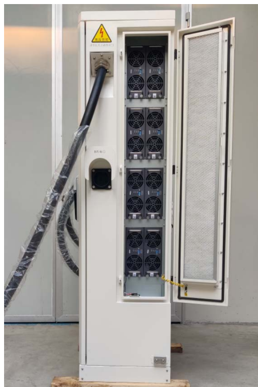
图 6 充电桩侧面内部
